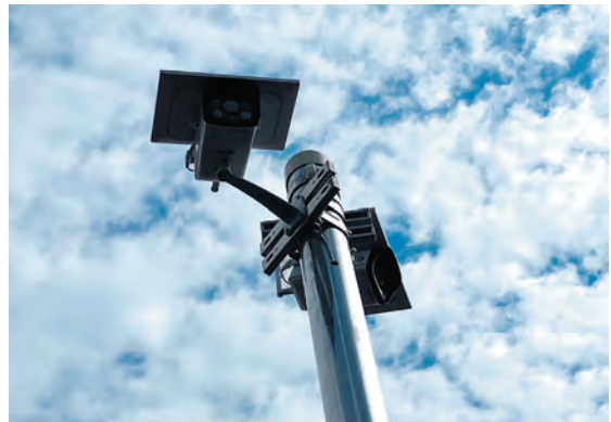
防犯カメラの設置
