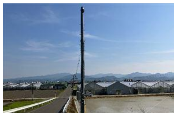
○河川監視カメラ設置
