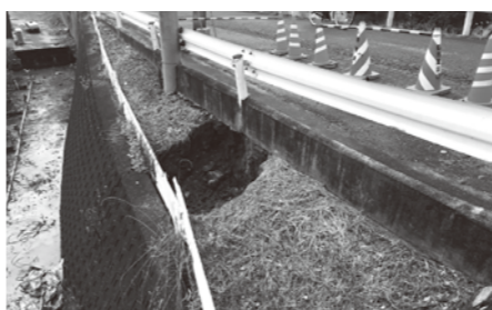
重ノ木地区の道路法面が陥没した箇所
