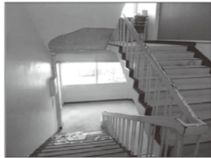
天井モルタルが落下した浜小
