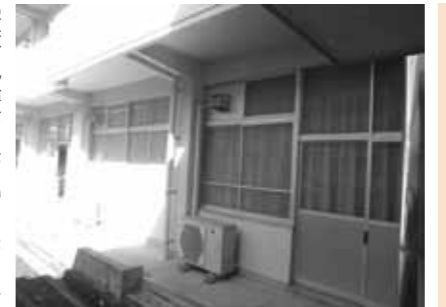
学校に設置されているエアコンの室外機。来年度、普通教室にはエアコンを設置する予定。
