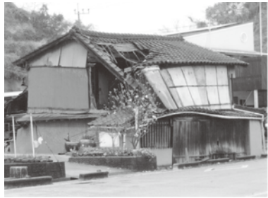
道路に面した危険家屋
