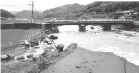
令和2年7月豪雨により決壊した浜川の 上古枝橋右岸付近
