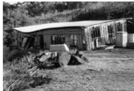
いつ倒壊してもおかしくない空き家の状況
