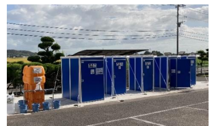
北鹿島小学校に整備された マンホールトイレ
