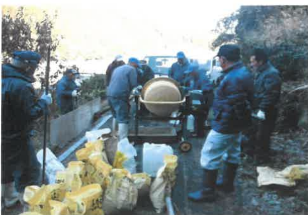
土穴 農道の補修 H31.1.27
