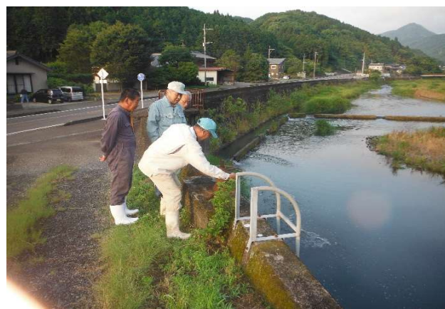
若殿分 施設の機能診断 R1.6.16
