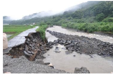
浜川護岸損壊
