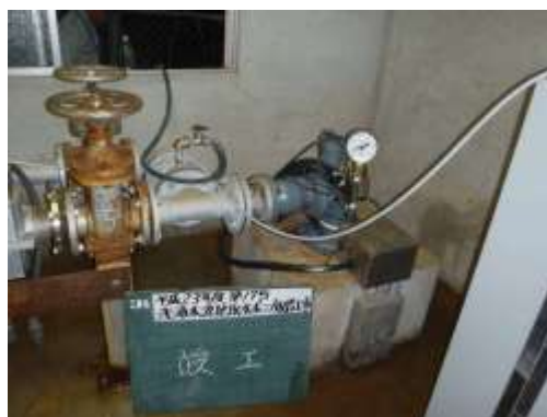
○浅浦水源地取水ポンプ(H23年度更新)
