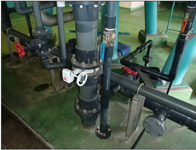
No. 1 配管設備 活性炭吸着塔配管 配管接合部：ボルト腐食、配管バルブ：腐食
