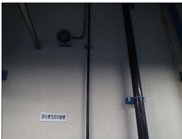
No. 81 土木・建築設備 地下ポンプ室 浄化槽汚泥中継槽壁部：液漏れ跡、ひび割れ
