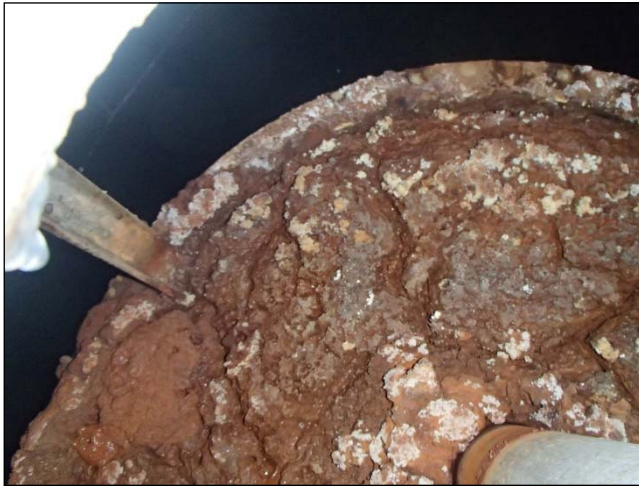
No. 9 高度処理設備 凝集汚泥掻寄機 駆動固定部：腐食
