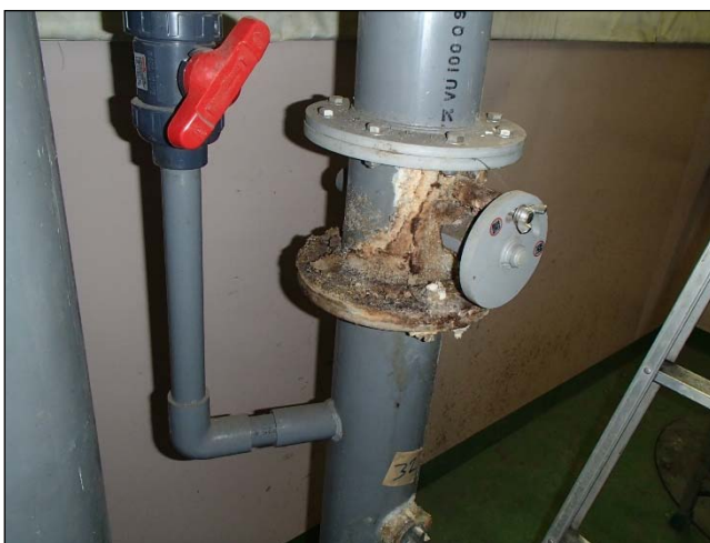
No. 5 配管設備 ブロワ室臭気ダクト ダンパ軸部：臭気漏れによる析出跡
