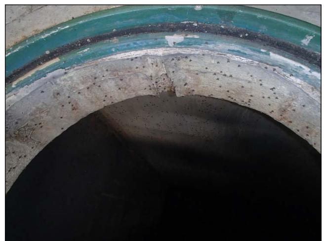
No. 150 土木・建築設備 浄化槽汚泥予備貯留槽 マンホール枠：防食劣化、亀裂、剥離
