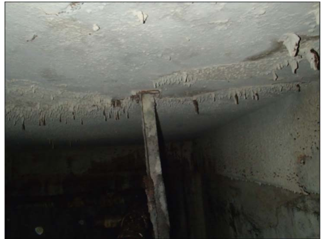
No. 148 土木・建築設備 し尿予備貯留槽 天井梁：防食劣化 配管サポート：腐食
