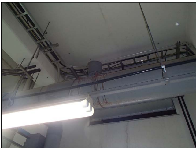
No. 9 配管設備 水槽上部室臭気ダクト 曝気槽上部（管理棟側）：配管フランジ部臭気漏れによる析出跡
