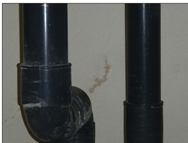
No. 84 土木・建築設備 地下ポンプ室 浄化槽予備貯留槽前天井：液漏れ
