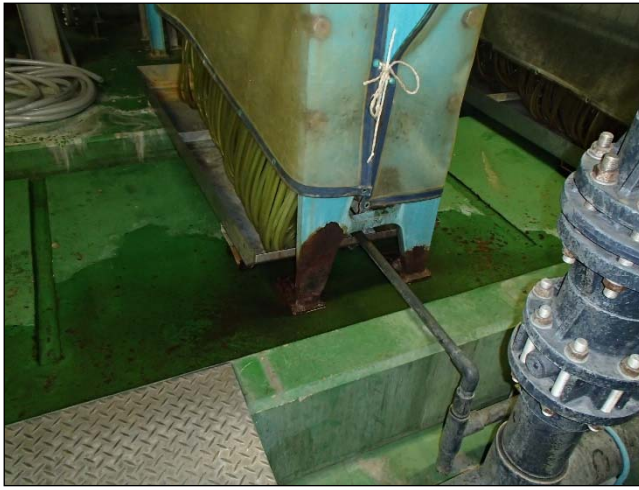
No. 7 主処理設備 No. 1生物膜分離限界ろ過装置 架台基礎部：腐食
