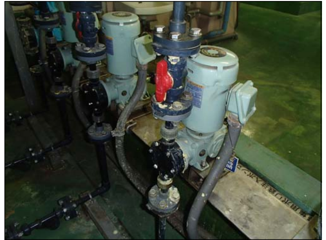
No. 10 高度処理設備 No. 2凝集用ポリテツ注入ポンプ 配管フランジ：スケール析出
