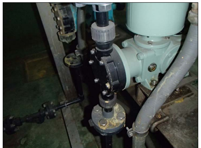
No. 12 汚泥処理設備 No. 3脱水用ポリテツ注入ポンプ 配管接合部：スケール析出
