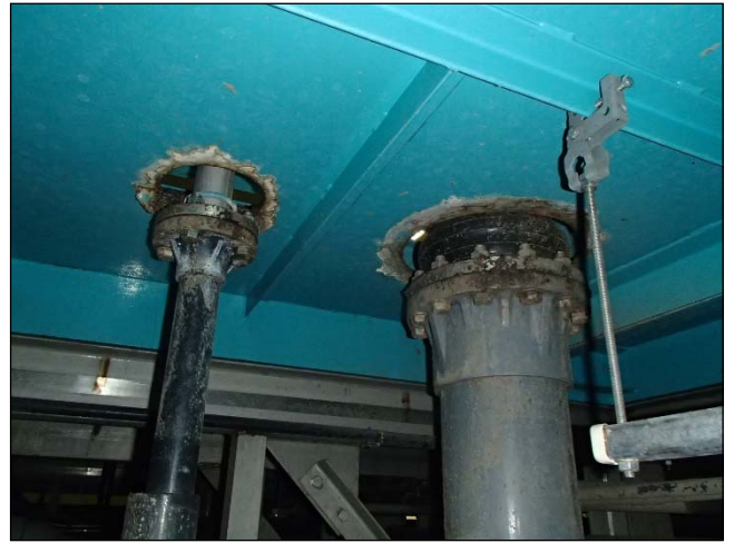
No. 2 配管設備 砂分離機配管 架台：配管貫通部劣化
