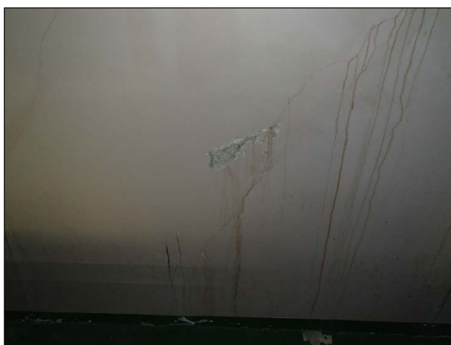
No. 83 土木・建築設備 地下ポンプ室 浄化槽予備貯留槽壁：ひび割れ、錆漏れ跡
