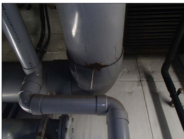
No. 12 配管設備 攪拌ブロウ上部臭気ダクト 配管接合部：液漏れによる析出
