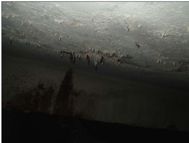
No. 147 土木・建築設備 し尿予備貯留槽 天井梁：防食劣化
