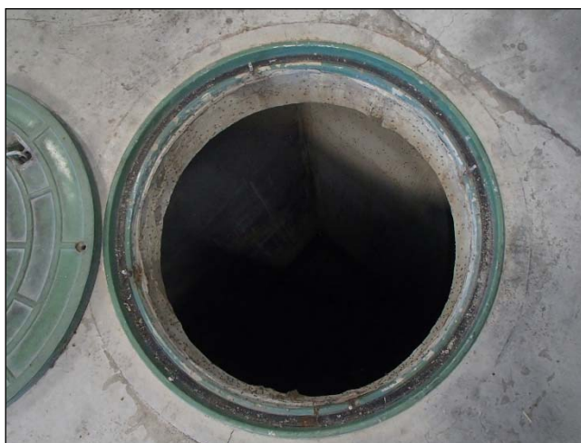
No. 149 土木・建築設備 浄化槽汚泥予備貯留槽 マンホール枠：防食劣化、亀裂、剥離
