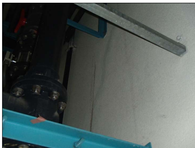
No. 82 土木・建築設備 地下ポンプ室 浄化槽汚泥中継槽壁部：液漏れ跡、ひび割れ
