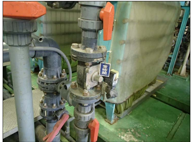
No. 4 配管設備 生物膜分離装置配管 配管フランジ：劣化
