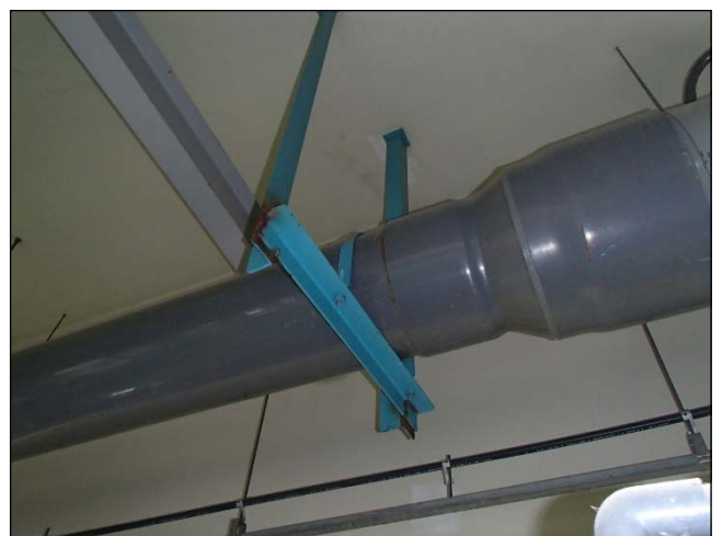
No. 6 配管設備 水槽上部室臭気ダクト 消泡剤貯槽上部：配管サポート一部腐食
