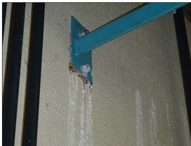
No. 80 土木・建築設備 地下ポンプ室 放流槽壁上部：配管サポート固定部液漏れ跡
