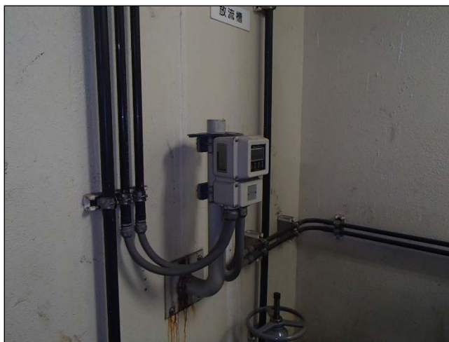
No. 79 土木・建築設備 地下ポンプ室 放流槽壁：計装機器固定部液漏れ跡
