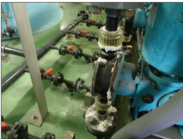
No. 11 高度処理設備 No. 2混和槽苛性ソーダ注入ポンプ 配管フランジ：スケール析出
