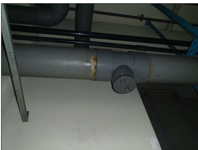
No. 11 配管設備 脱臭設備制御盤前臭気ダクト 配管接合部：液漏れによる析出
