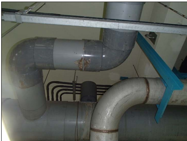
No. 7 配管設備 水槽上部室臭気ダクト 消泡剤貯槽上部：配管接続部臭気漏れ跡
