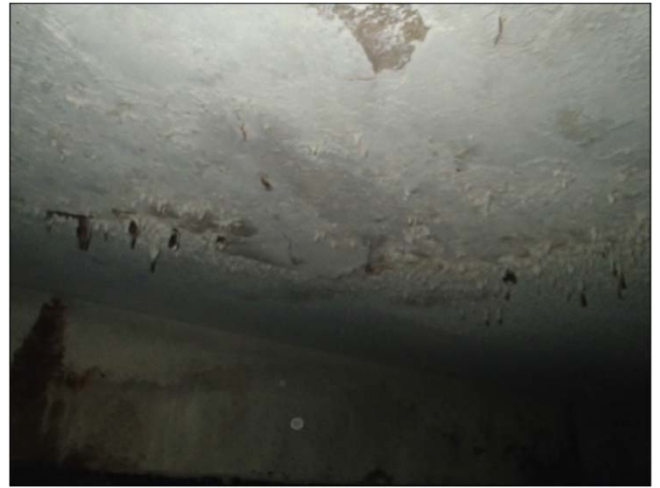
No. 146 土木・建築設備 し尿予備貯留槽 天井：防食劣化（硫化水素ガスによるつららあり）、防食膨れ
