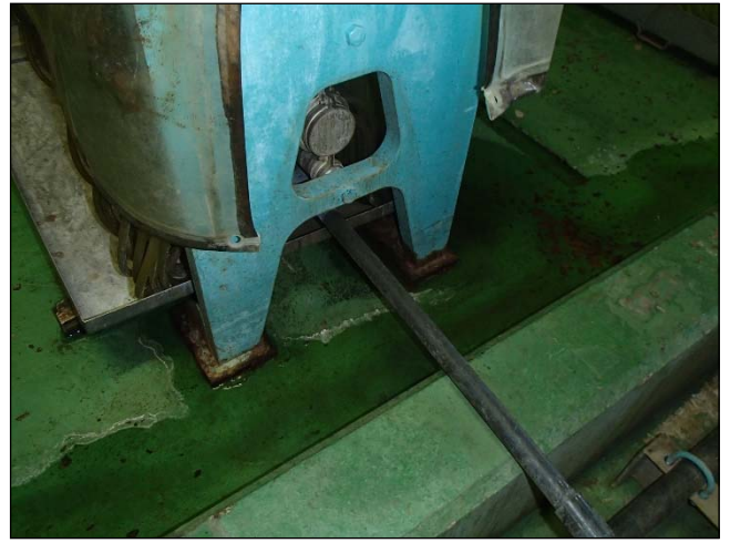
No. 8 主処理設備 No. 2生物膜分離限界ろ過装置 架台基礎部：腐食
