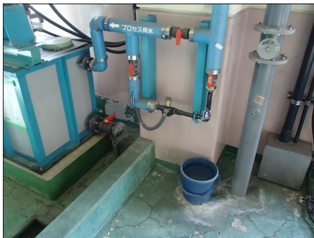
No. 10 配管設備 プロセス用水配管 水漏れ（メタノールサービスタンク横）
