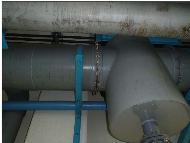
No. 8 配管設備 水槽上部室臭気ダクト 消泡剤貯槽上部：配管フランジ部臭気漏れによる析出跡
