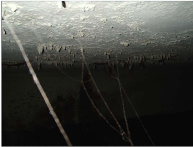
No. 145 土木・建築設備 し尿予備貯留槽 天井：防食劣化（硫化水素ガスによるつららあり）、防食膨れ
