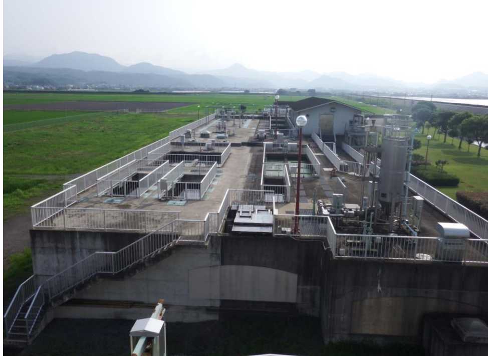
▲鹿島市浄化センター(標準活性汚泥法)
