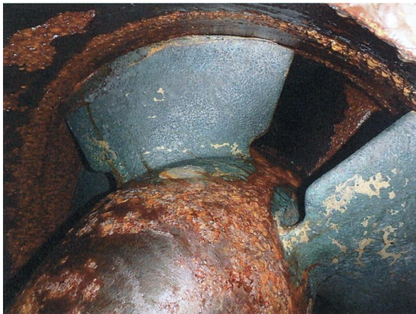
南舟津雨水ポンプ場 主ポンプ シャフト・インペラ 発錆・腐食
