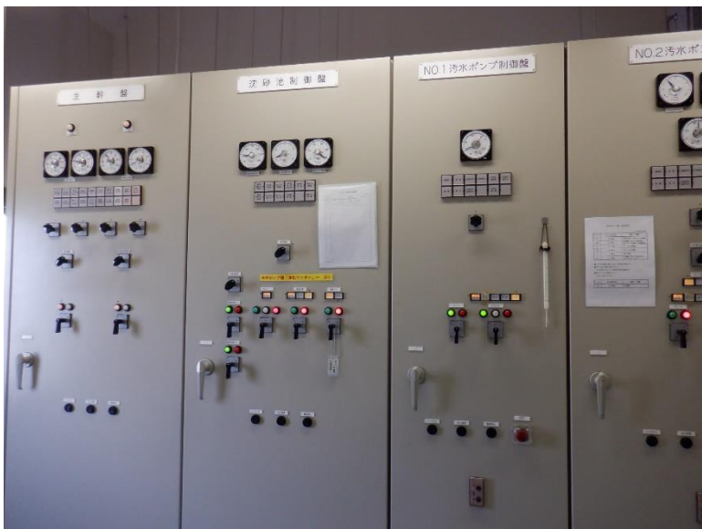
▲ポンプ場の制御盤
