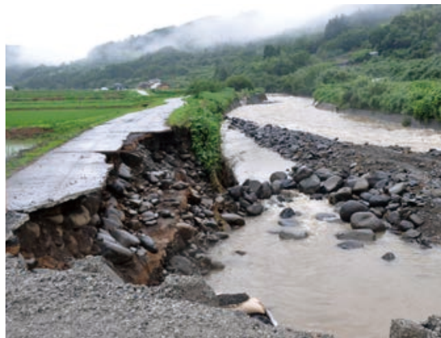
令和2年7月 浜川護岸損壊
