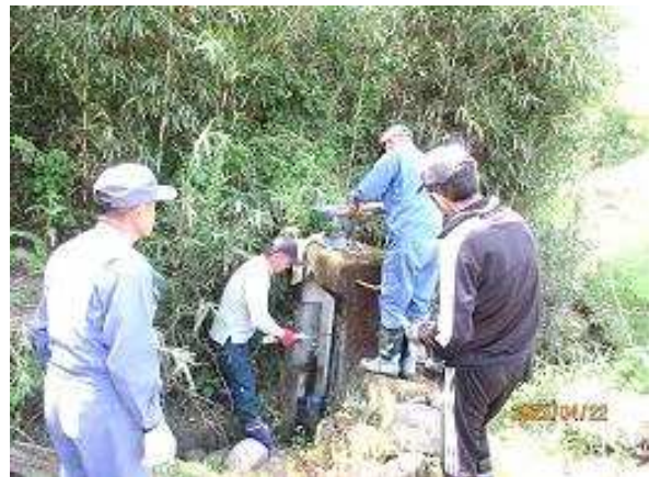
川内区 かんがい期前の注油
