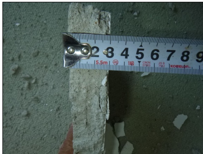
落下したモルタル
