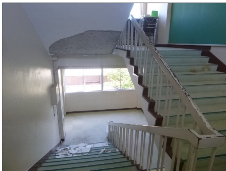
階段裏天井モルタルが落下
