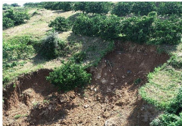
○R5 年災 音成農地被災状況
